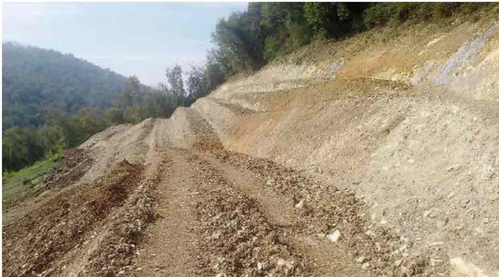
Lavori in corso. Ruspe e scavatori hanno ripreso le loro attività lo scorso mese di giugno
